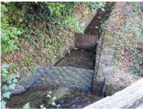
Figure 2: grilles installées sur le canal au niveau de la prise d'eau du ravin de la Bastide
